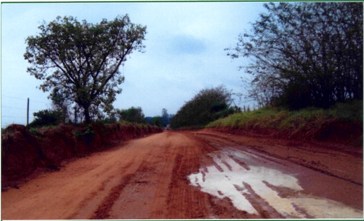
Estrada encaixada sem drenagem superficial lateral.
