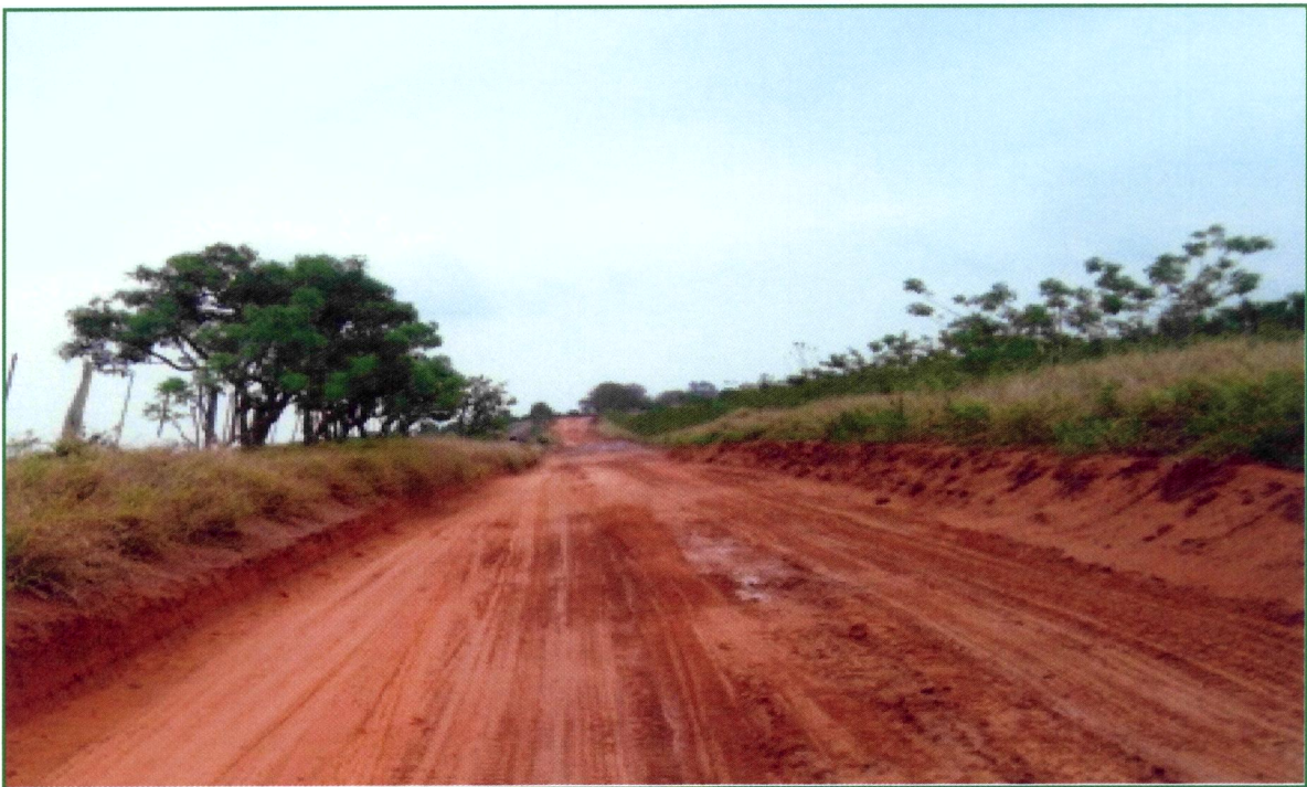
Acumulo de areia proveniente da arrastamento provocado pela enxurrada
